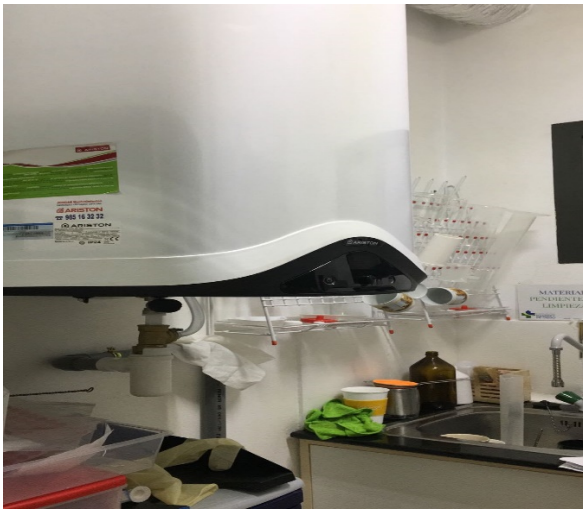
Nueva bomba de calor del establecimiento
