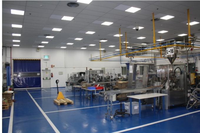
Planta y nuevas luminarias instaladas
