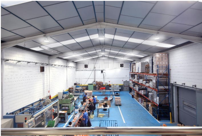
Nuevos paneles y nueva luminaria de una de las plantas
